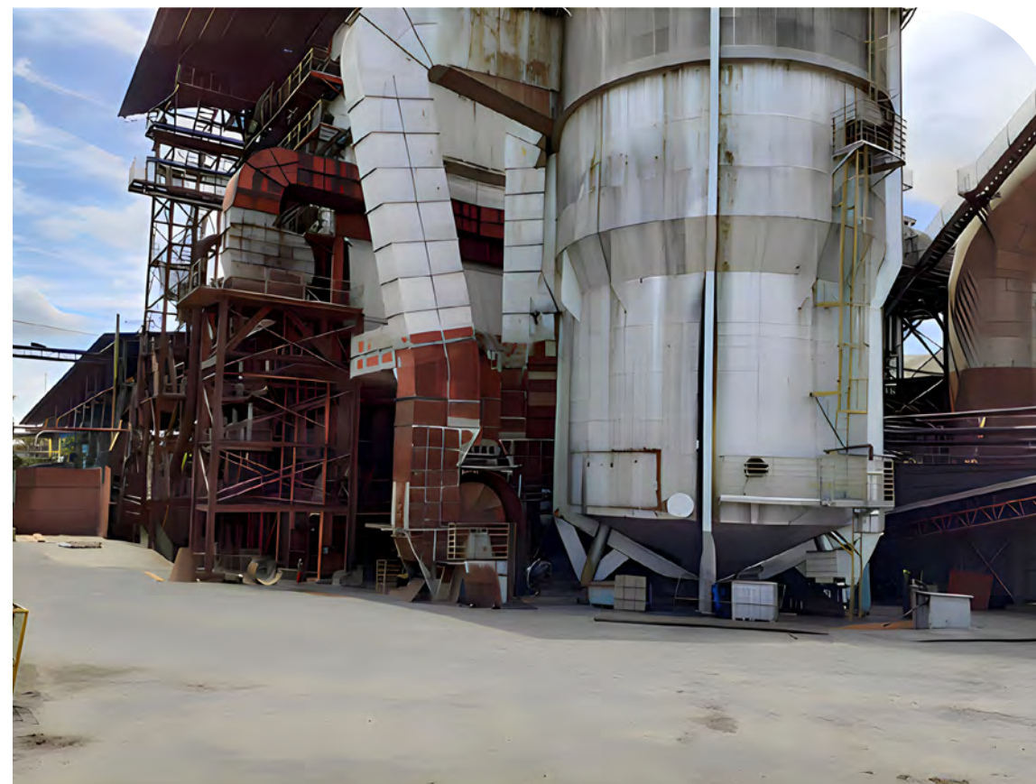
Sistema de controle de poluição ambiental da área industrial – Lavador de gases unidade Ariranha
